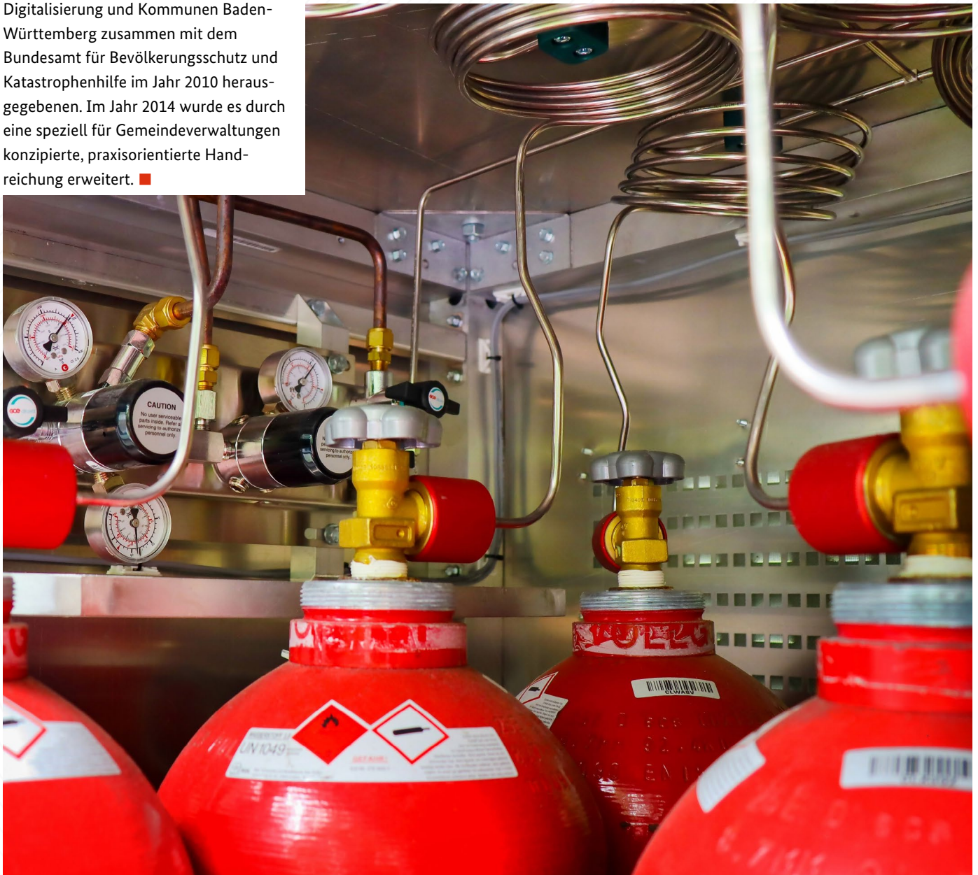
Wasserstoffversorgung der Netzersatzanlage
