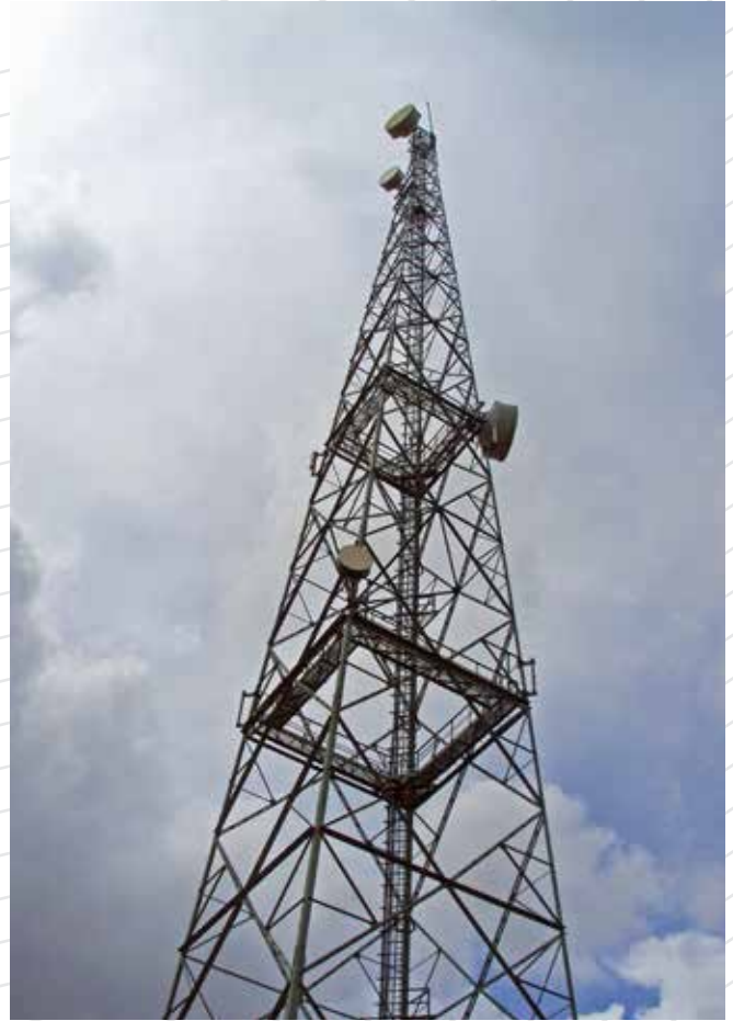
Fertige Digitalfunk-Antennenanlage, beide Bilder dieser Seite: AS TH.
