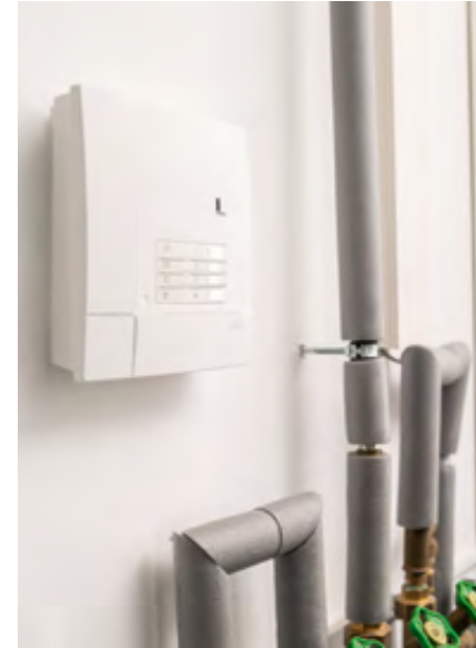
^ Zentrale einer Alarmanlage im Haustechnikraum
